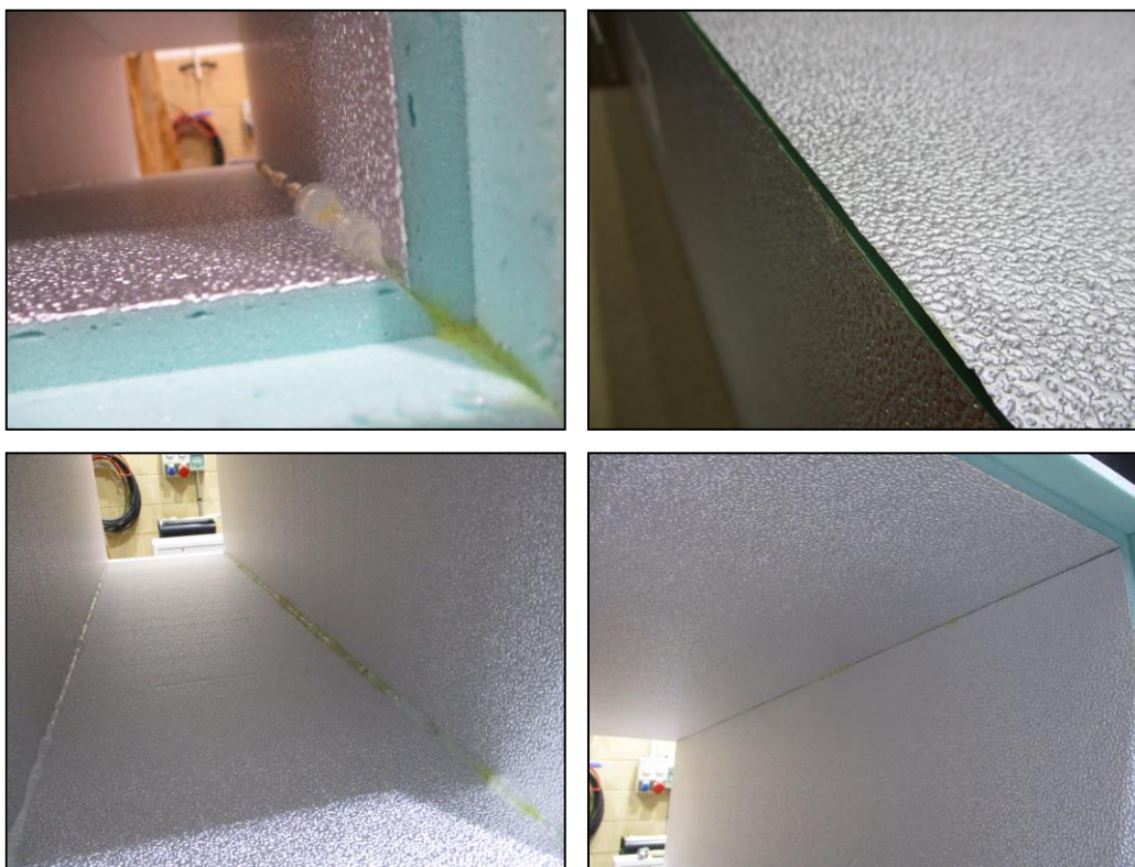
Foto N°.2. Detalles de la unión longitudinal
